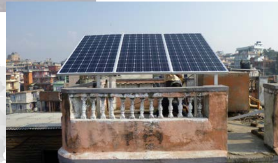
Lieu : Népal Taille du système : 570W Type de construction : Installation résidentielle autonome Fin des travaux : 2012 Installateur : Solar Solutions
