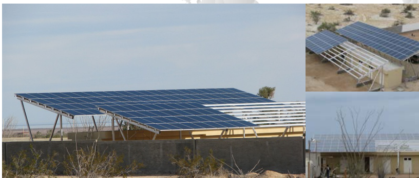
Lieu : Mexique Taille du système : 28,8kW Type de construction : Abri de parking PV Fin des travaux : 2012 Installateur : Voltaika
