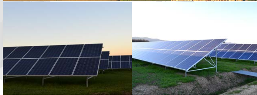
Lieu : Italie Taille du système : 10MW Type de construction : Centrale au sol Fin des travaux : 2011 Installateur : Cellini
