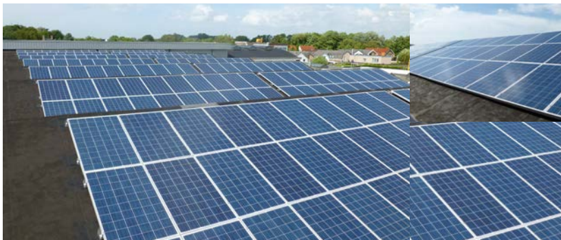
Lieu : Pays Bas Taille du système : 115,2kW Type de construction : Toit industriel Fin des travaux : 2011 Installateur : SolarNRG
