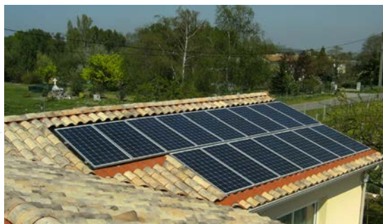
Lieu : Divers, France Type de construction : Intégré au bâti Fin des travaux : 2011 Installateur : AEG Aquitaine
