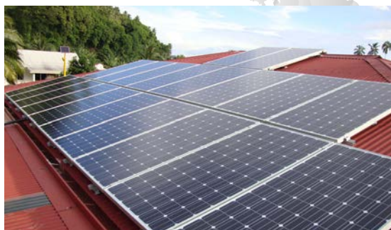
Lieu : Divers, Polynésie Française Type de construction : Intégration simplifiée Fin des travaux : 2012 Installateur : Conexun
