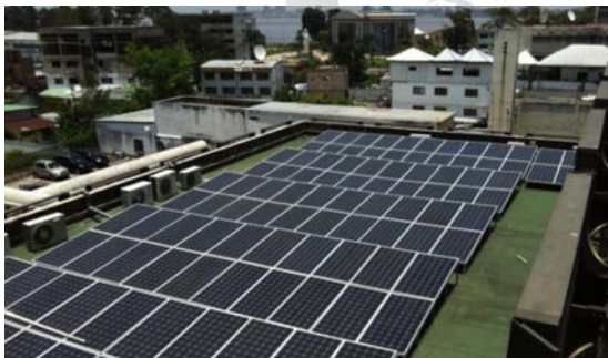
Lieu : République du Congo Taille du système : 19,8kW Type de construction : Toit industriel, installation autonome Fin des travaux : 2011 Installateur : Itoua's technologies
