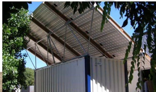
Lieu : Madagascar Taille du système : 3,8kW Type de construction : Conteneur photovoltaïque Fin des travaux : 2011 Installateur : IE Solar
